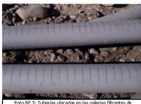
Foto N° 3: Tuberías ubicadas en las galerías filtrantes de
