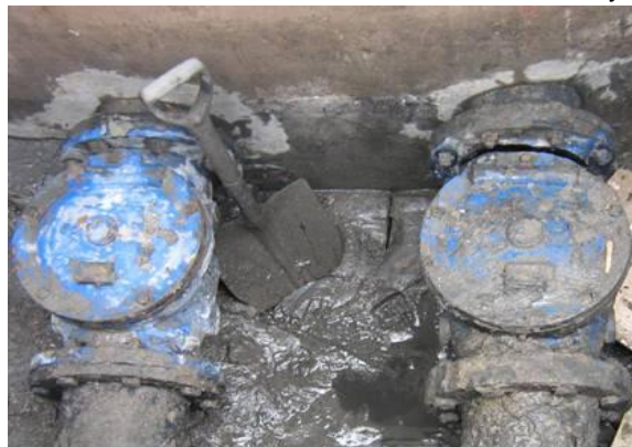
Colapso de la cámara de bombeo de Leticia
