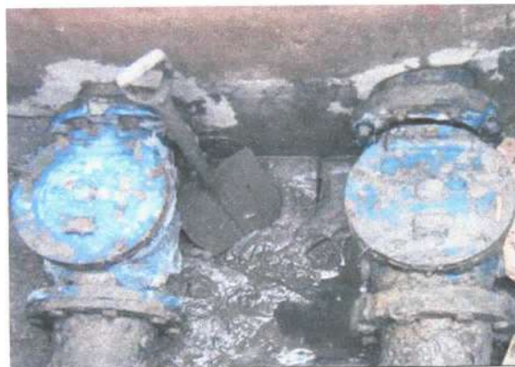
Figura 10: Colapso de las cámaras de bombeo de Leticia
