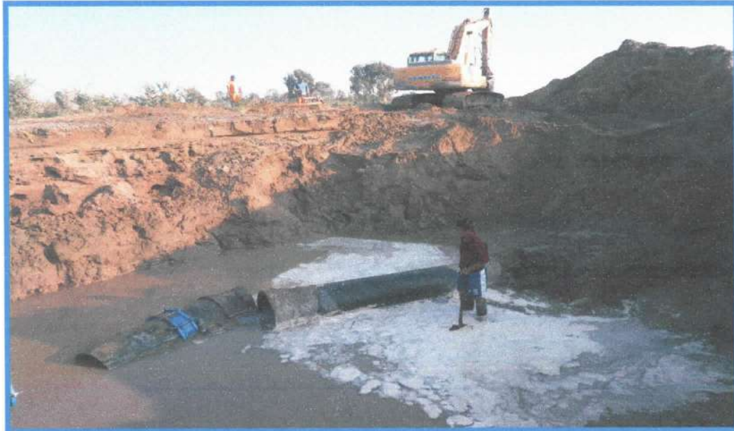
Figura 11: Daños originado en los sistemas de Agua Potable y Saneamiento debido a un Tsunami
