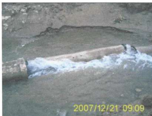
Figura 06: Tubería dañada de la Red de Agua
