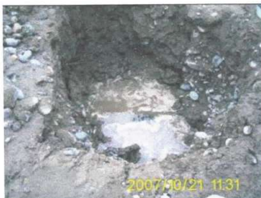
Figura 08: Daño de las conexiones Domiciliarias de Agua Potable
